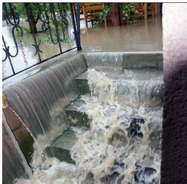
... und ohne entsprechenden Schutz zu Überflutungen am Haus führen.
